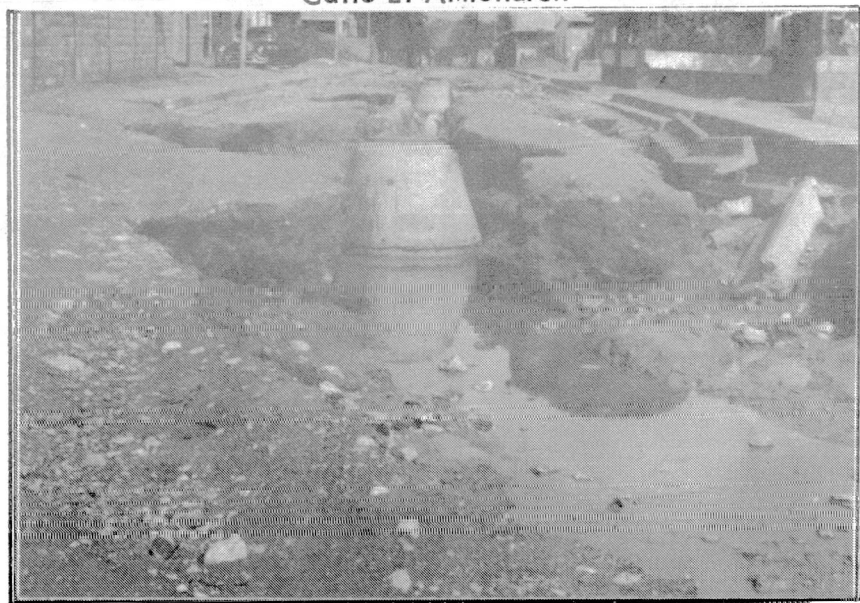
Cloacas al descubierto
