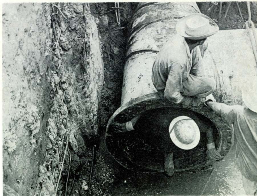
Aquí se ve el tubo de empalme en "T" que une en Caracas la tubería nueva con la vieja.
