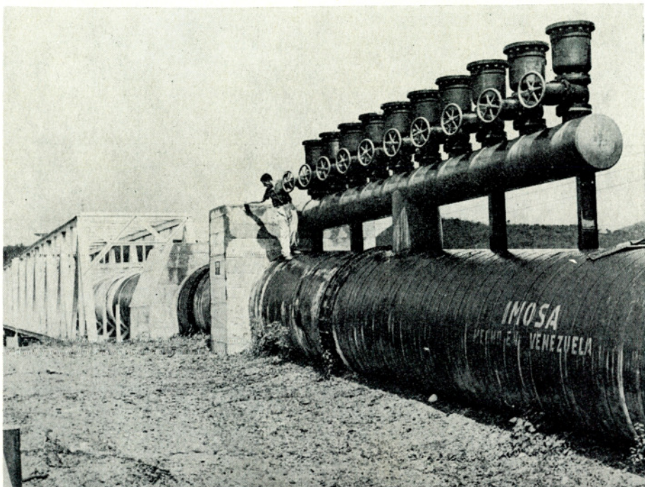
Tubería entre Lagartijo y Estación Nº 1. Puede verse una batería de ventosas.
