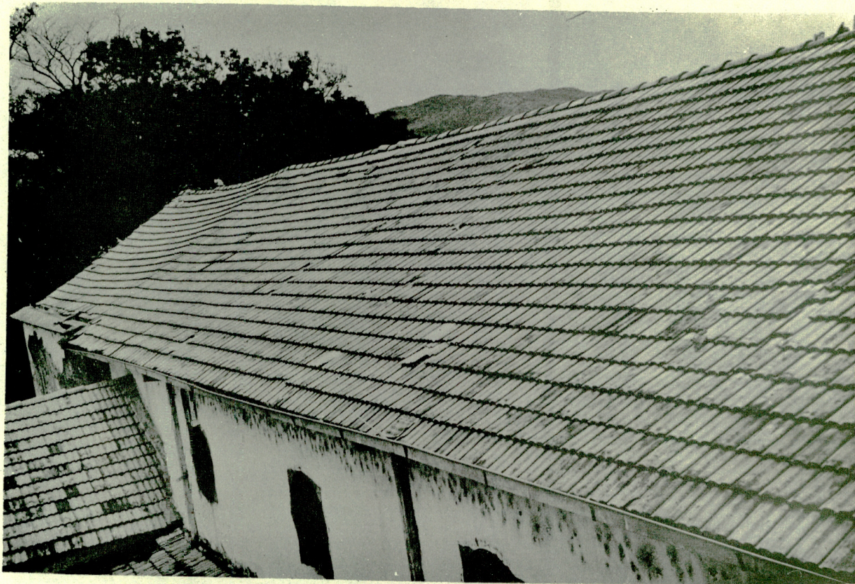
ESTADO ACTUAL DE LOS TECHOS DE LA IGLESIA (GUIGUE)
