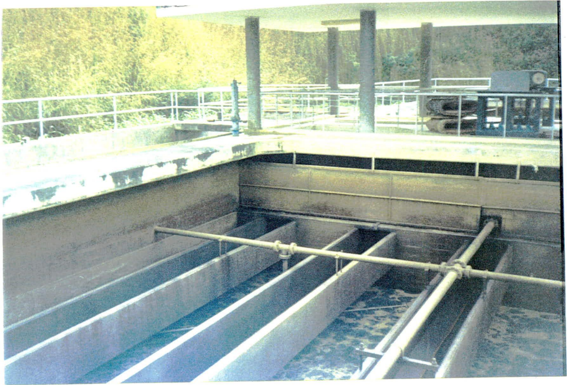
SALA FILTROS "B" : Filtro PAR en modo seco
