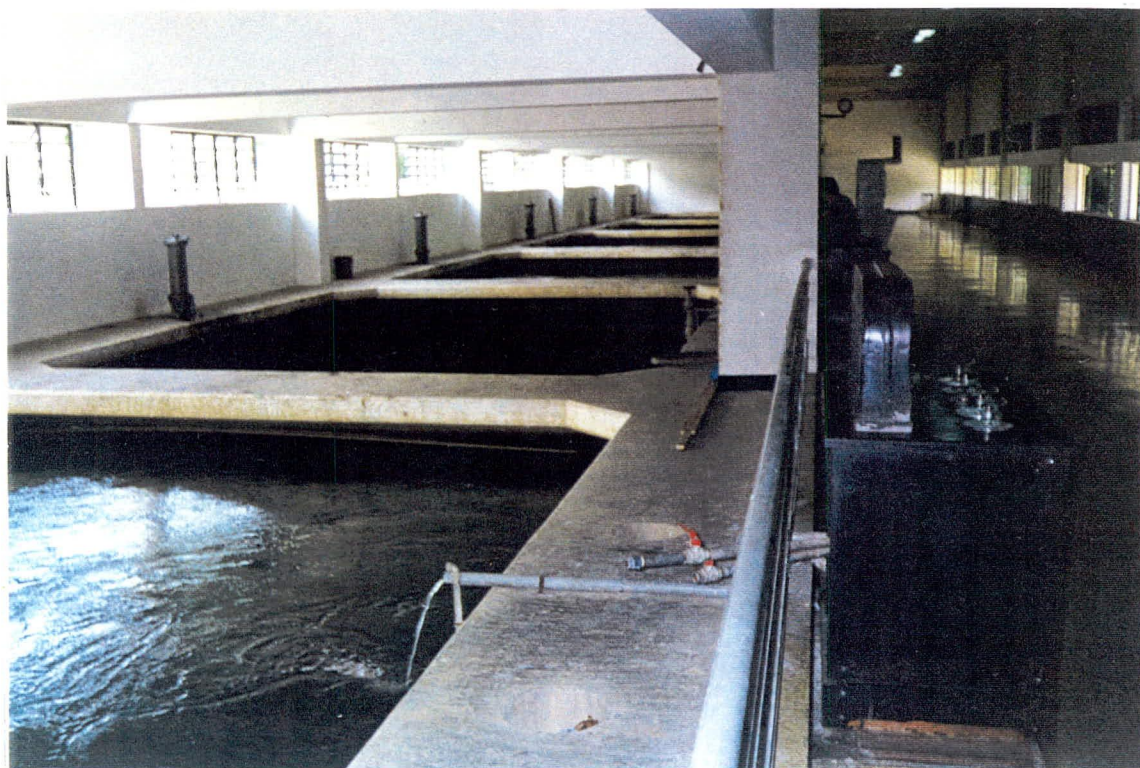
SALA DE FILTRACION "A" : VISTA GENERAL
