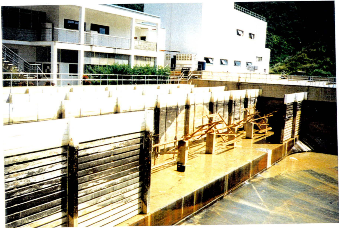
FLOCULADORES "A" : Todos FUERA de SERVICIO
