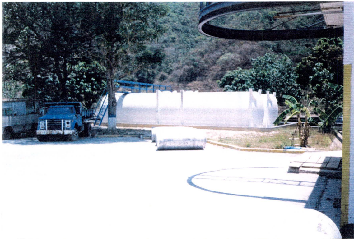
CISTERNAS CON SULFATO DE ALUMINIO LIQUIDO.-
