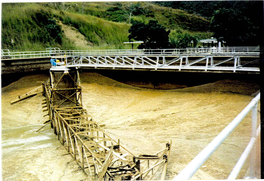
SEDIMENTADORES "A" : Barrelados FUERA de SERVICIO
