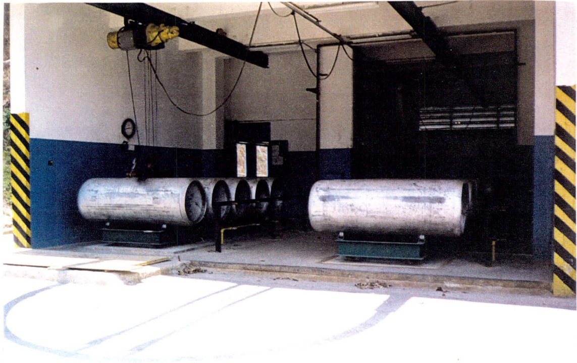
DEPOSITO DE CILINDROS DE CLORO.-
