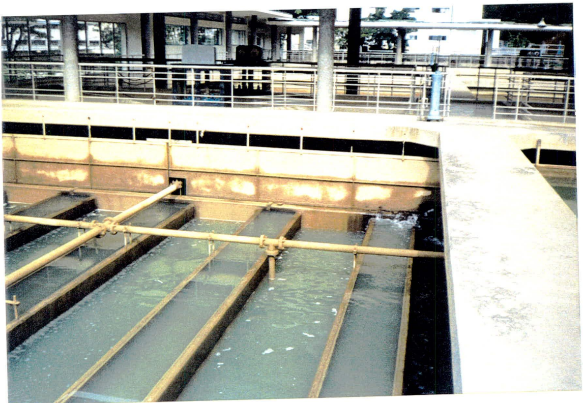
SALA FILTROS "B" : Filtro PAR lavado
