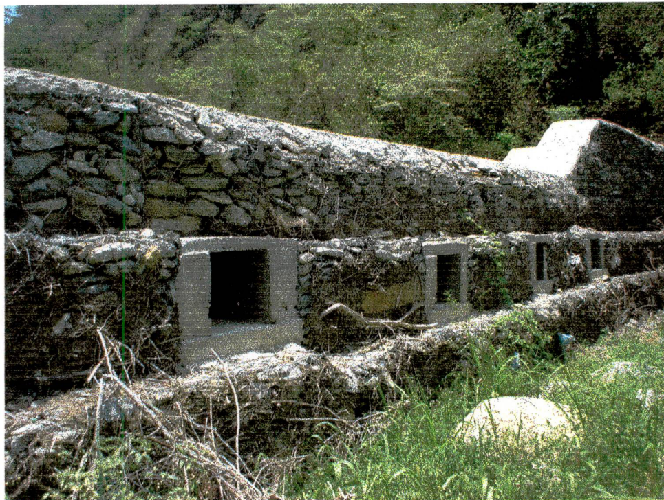
Camurí Grande- Presa n°1 (desde aguas arriba)- Nótese el cimacio sin rematar
