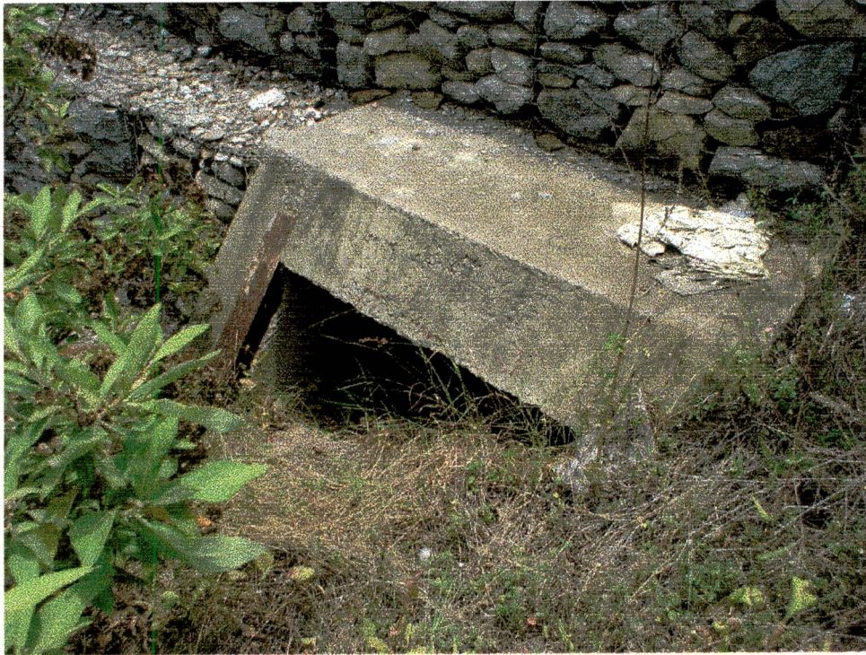
Quebrada Camurí Chico- Ventana casi totalmente obstruida (n° 8)
