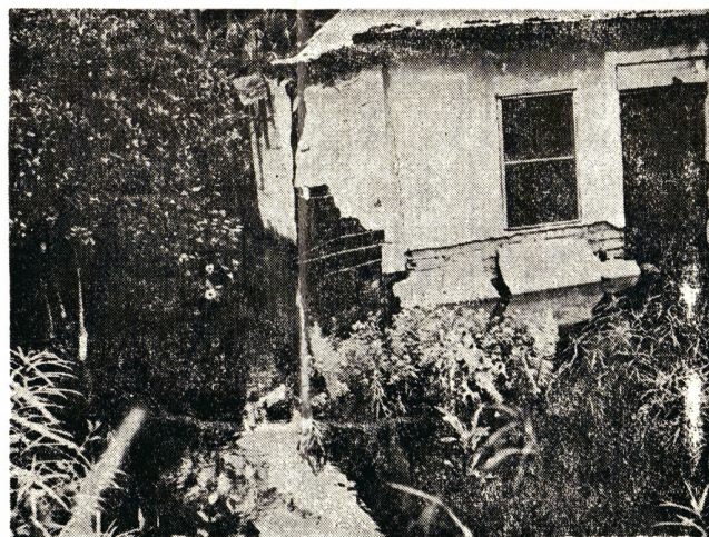
El espectáculo que ofrece esta vivienda parcialmente destruida, es escena corriente en la capital del Distrito Colón, aún bajo el efecto de las aguas del Escalante. — (Foto Villegas).
